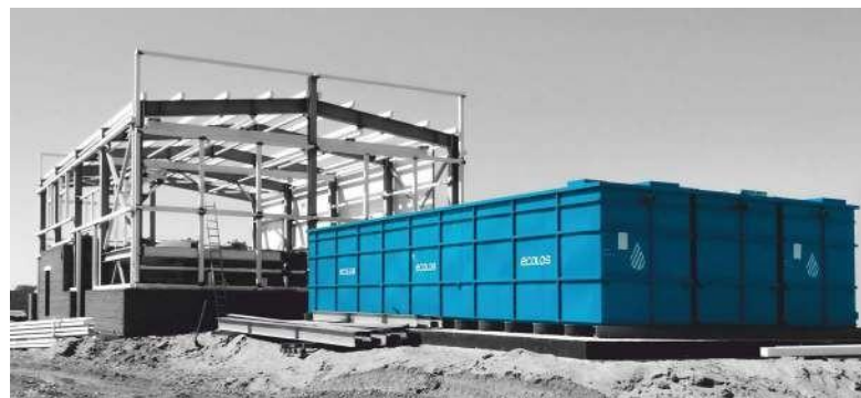
РП. КОЧЕНЕВСКИЙ, НОВОСИБИРСКАЯ ОБЛАСТЬ Оборудование производительностью 2 990 м 3 /сут (Хозбыт, ливневка, промсток)
