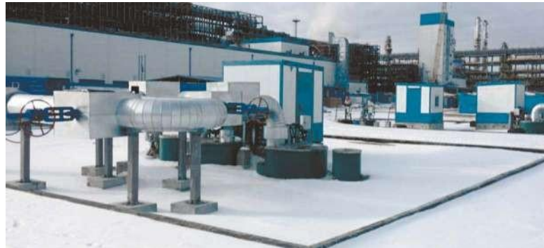
Г. ТОБОЛЬСК, ТЮМЕНСКАЯ ОБЛАСТЬ ООО «СИБУР ТОБОЛЬСК» Канализационные насосные станции производительностью 350-720 м 3 /сут
