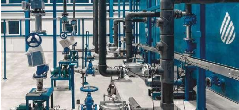
П.КРАСНЫЙ ЯР, ОМСКАЯ ОБЛАСТЬ АО «ЛЮБИНСКИЙ МКК» Станция очистки сточных вод производительностью 1 000 м 3 /сут
