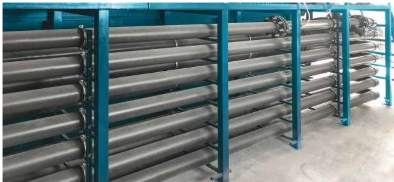
Г.ВОРОНЕЖ, ВОРОНЕЖСКАЯ ОБЛАСТЬ МКК «7 УТРА» Станция очистки сточных вод производительностью 900 м 3 /сут
