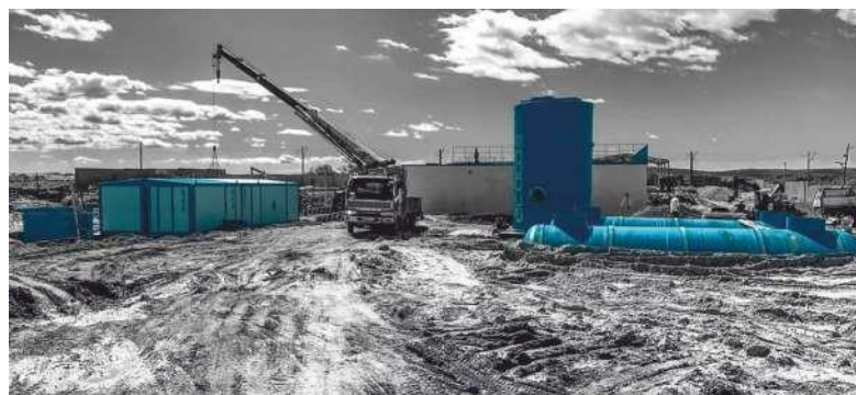
С. МИХАЙЛОВКА ПРИМОРСКИЙ КРАЙ Станция очистки сточных вод производительностью 1 500 м 3 /сут
