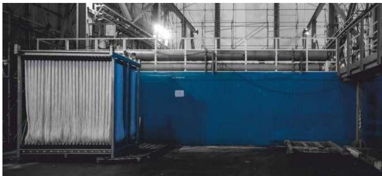
ЗАО «АНТИПИНСКИЙ НПЗ» ТЮМЕНСКАЯ ОБЛАСТЬ Оборудование ЛОС-МБР-7900 на основе мембранного биореактора
