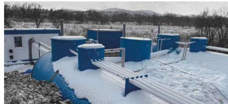
С. ЯКОВЛЕВКА - 1 / ЯКОВЛЕВКА - 2 ПРИМОРСКИЙ КРАЙ Станция очистки сточных вод производительностью 120/500 м 3 /сут
