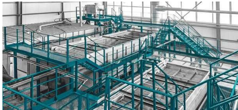
Г.РУЗАЕВКА, РЕСПУБЛИКА МОРДОВИЯ ЯЙЦЕПЕРЕРАБАТЫВАЮЩАЯ ФАБРИКА «РУЗОВО» Станция очистки сточных вод производительностью 600 м 3 /сут
