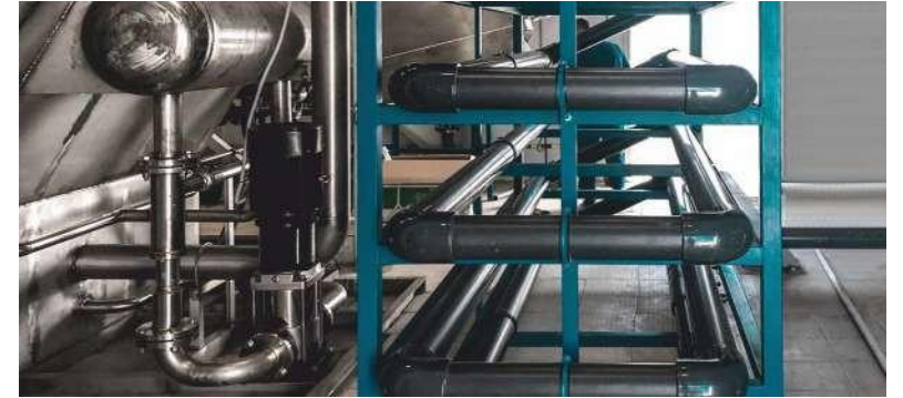
Г. НЕВИННОМЫСК, СТАВРОПОЛЬСКИЙ КРАЙ «КАЗЬМИНСКИЙ» МК Станция очистки сточных вод производительностью 300 м 3 /сут
