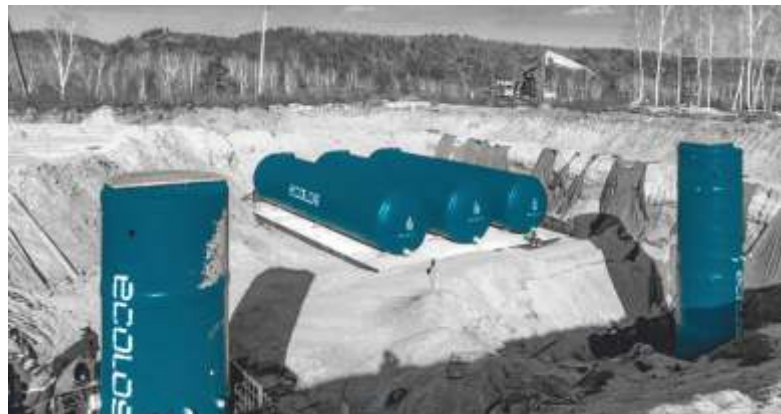
Очистные сооружения хозяйственно-бытовых сточных вод ЛОС-Р-500 м 3 /сут. с. Яковлевка
